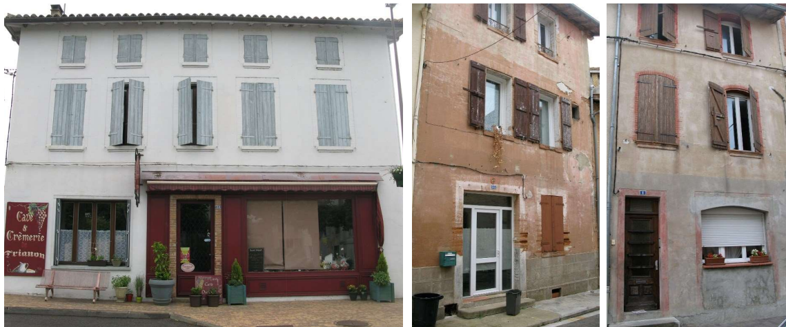
Les rez-de-chaussée, les boutiques, les percements. Symétrie des façades brisée. Non respect des gabarits, des travées, des éléments qui règlent l'art de composer la façade harmonieuse.
