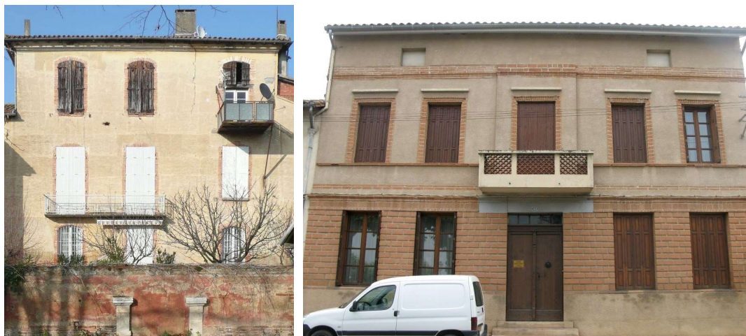
Les matériaux inappropriés : balcons ajoutés ou remaniés, composition de façades déséquilibrée, matériaux anachroniques.
