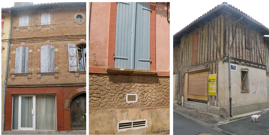
Les matériaux inappropriés : briques anciennes et briques neuves, mélange des tons. Imitation d'un parement de moellons en enduit ciment sur une maison de briques et problème de l'insertion des dispositifs d'aération.
